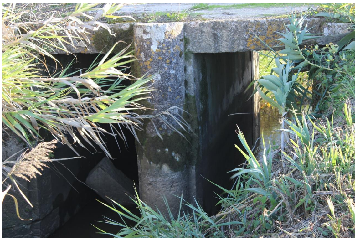
Figura 3 – Pormenor da estrutura do duplo cubo , sendo visível um elemento da estrutura tombado no interior
